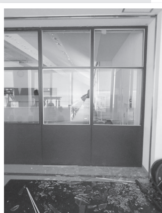
再び地震被害を受けた体育館トレーニング室
