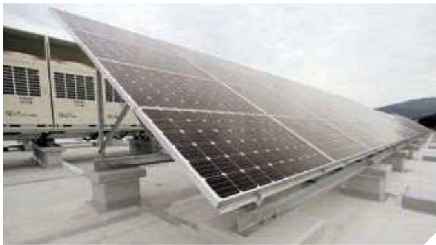
▲太陽光発電した電気は庁舎内で常時活用されます。
