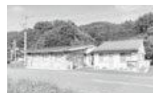
老朽化した大綱木公民館
