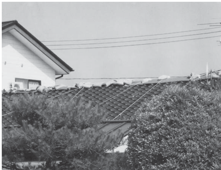
東日本大震災により被害を受けた住宅
