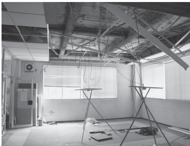
地震により大きな被害を受けた役場電算室
