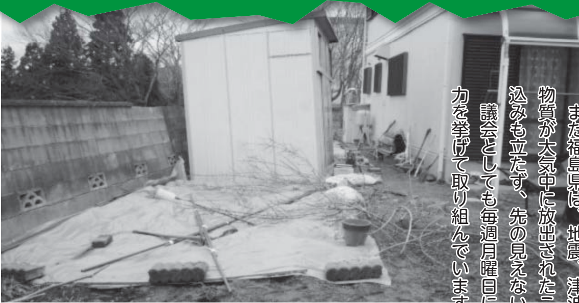
地震により被害を受けた住宅地（東大清水地内）
