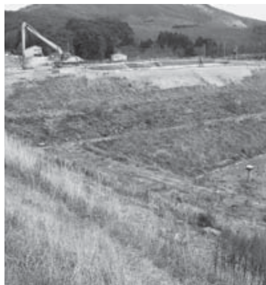
震度5で崩壊の恐れのある処分場土堰堤
