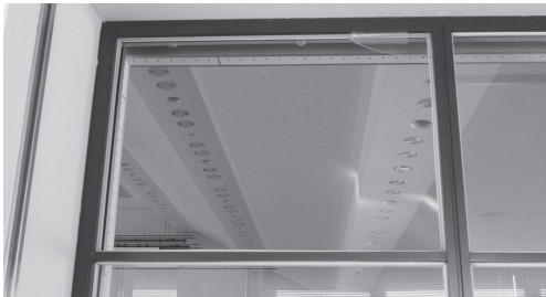
破損したトレーニング室のガラスと屋根
