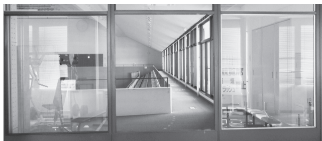
地震でガラスの割れたトレーニング室 ※現在は修繕され利用可能です
