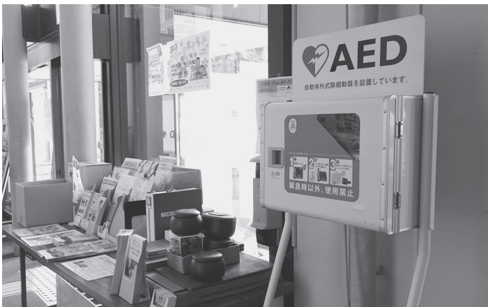
中央公民館に設置されているAED（1階と3階に設置）
