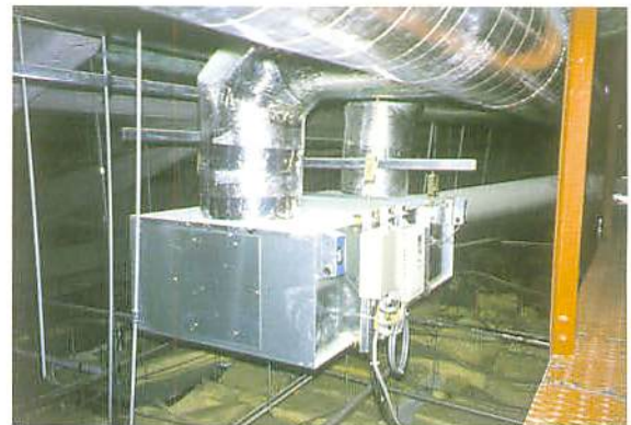
ハンドリングボックス・集熱棟ダクト
