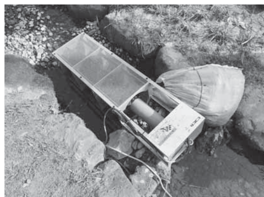
水路を利用した小水力発電（石川県能登町）
