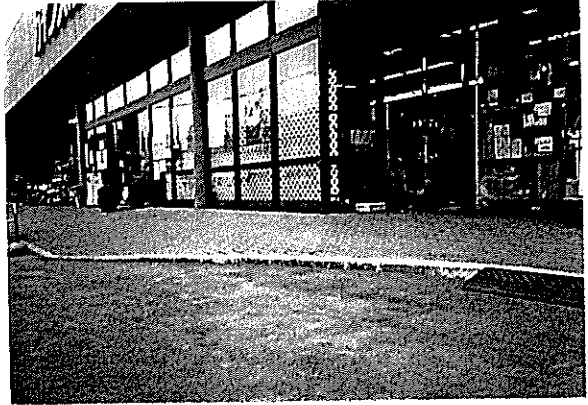
途中で勾配が変わるスロープや一部陥没しているタイルブロックは使いづらい
