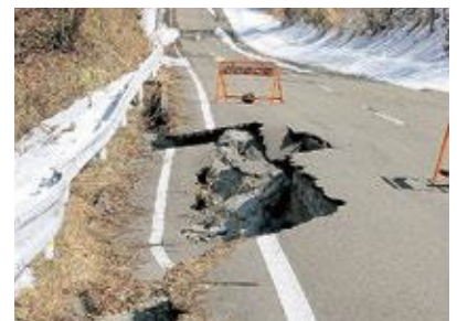
小綱木地区 越中田・下長橋線 路面陥没(平成23年3月12日)
