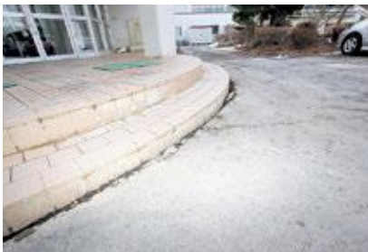
山木屋小学校 昇降口の沈下 (平成23年3月11日)
