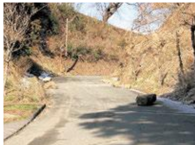
飯坂地区 花塚後沢線 落石(平成23年3月12日)
