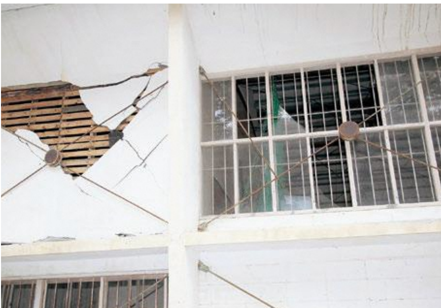
山木屋中学校 体育館の壁崩落、ガラス破損（平成23年3月11日）
