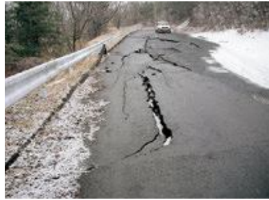
小島地区 原・萩平線 路面亀裂(平成23年3月11日)
