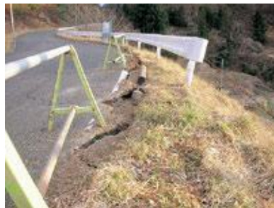
小綱木地区 大柴線 路面亀裂(平成23年4月4日)
