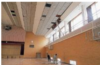
川俣中学校 体育館の天井材崩落 （平成23年4月8日）
