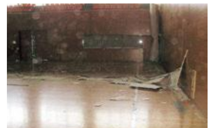
町体育館 天井材崩落の直後 (平成23年3月11日)
