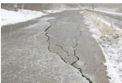
小島地区 原・萩平線 路面亀裂(平成23年3月11日)
