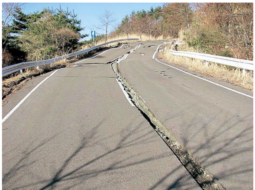
飯坂地区 花塚線 路面陥没、亀裂(平成23年3月12日)
