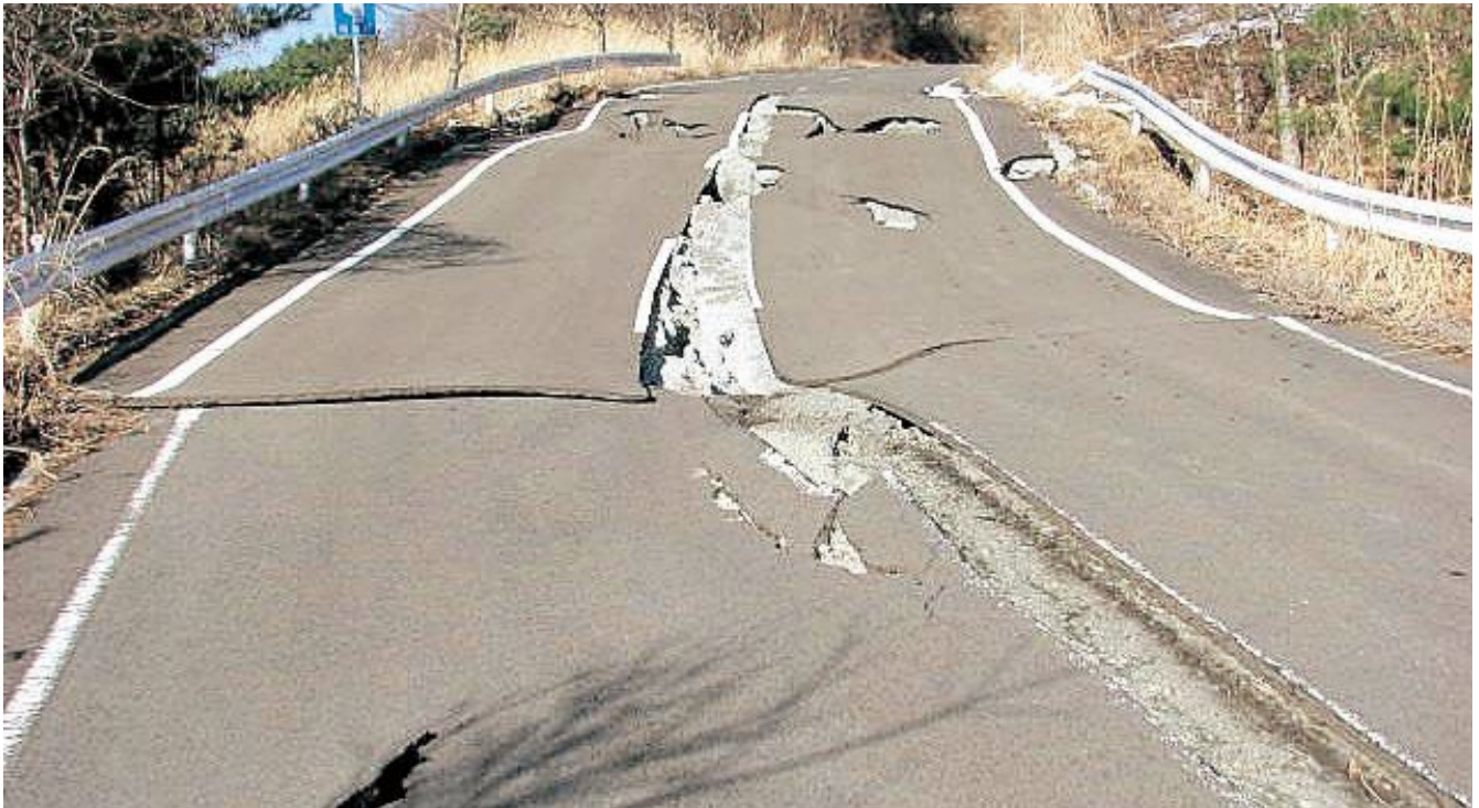
飯坂地区 花塚線 路面陥没、亀裂(平成23年3月12日)
