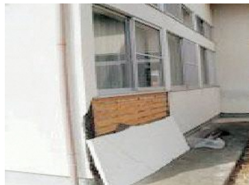
飯坂生活改善センター 外壁崩落 (平成24年1月30日)
