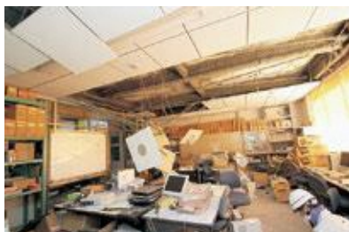
庁舎 事務所の天井材崩落 （平成23年3月12日）
