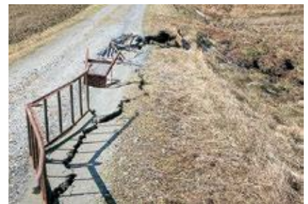
小神地区 山王線 路肩崩落 (平成23年3月18日)
