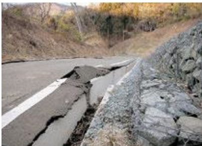
小綱木地区 田代線 路面隆起(平成23年4月4日)
