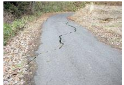
小綱木地区 花塚後沢線 路面亀裂(平成23年4月4日)
