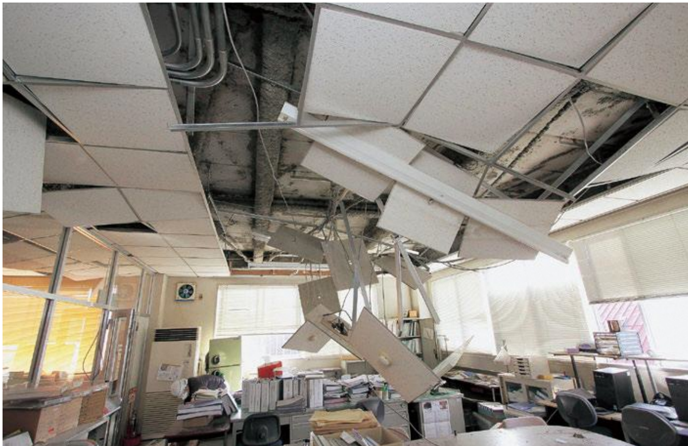
庁舎 事務所の天井材崩落（平成23年3月12日）
