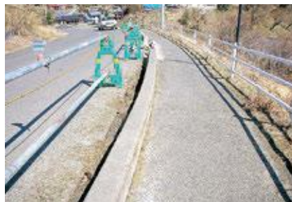
小神地区 鍛冶内・壱貫田線 富田小学校前の縁石崩壊 (平成23年3月18日)
