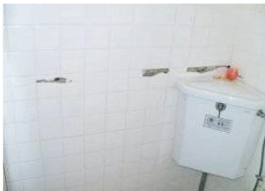
飯坂生活改善センター トイレ壁破損 (平成24年1月30日)
