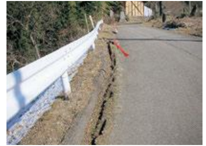
飯坂地区 山下・上成栗線 路面亀裂(平成23年3月11日)
