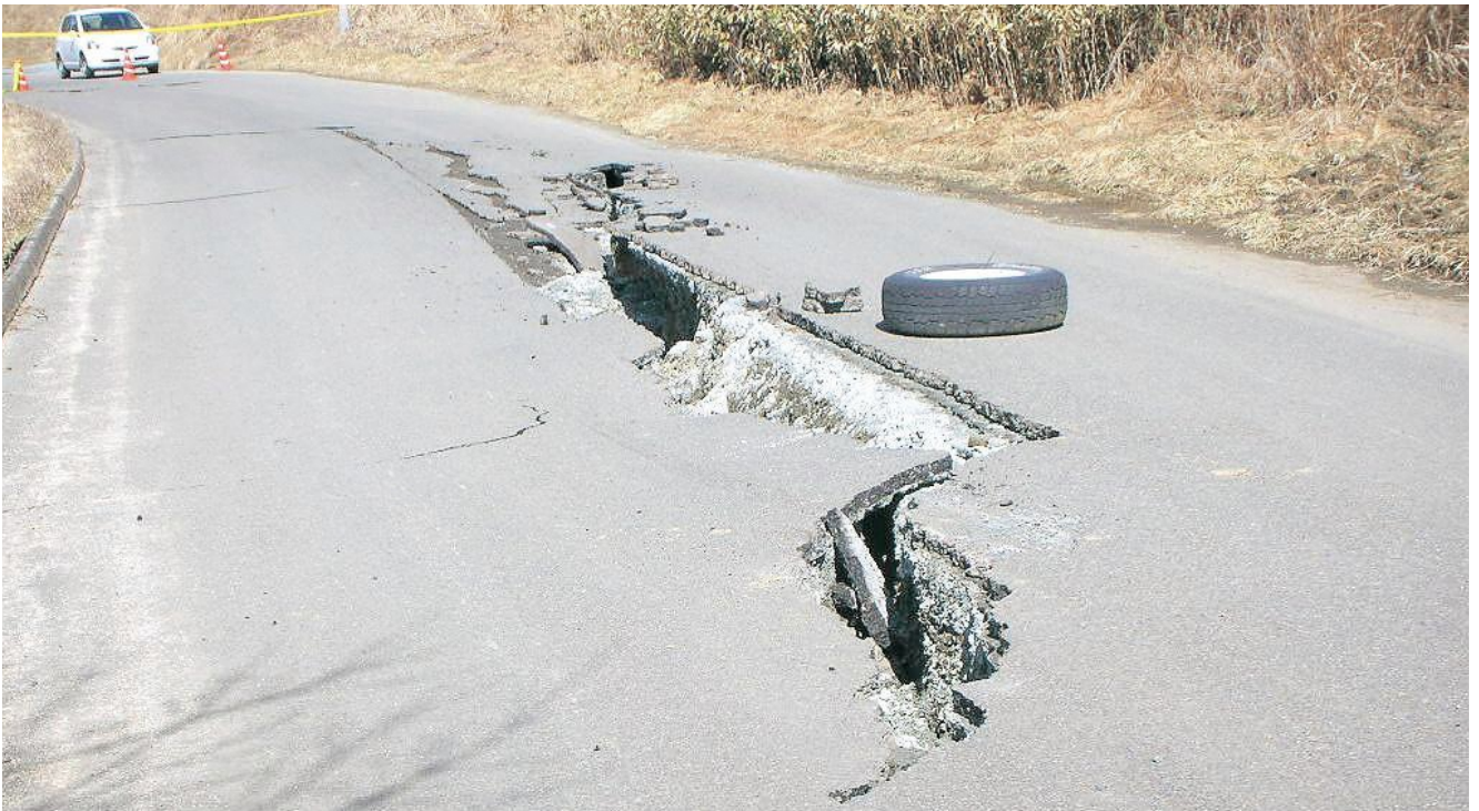
山木屋地区 山木屋田代線 路面陥没、亀裂(平成23年3月12日)
