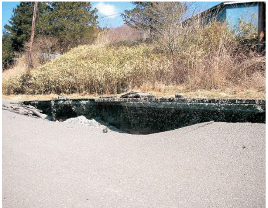
山木屋地区 山木屋田代線 路面陥没(平成23年3月12日)
