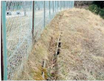
農村広場 排水路破損 (平成24年1月30日)
