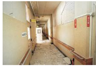
庁舎 廊下の壁崩落 （平成23年3月12日）
