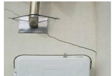
飯坂生活改善センター 外壁亀裂 (平成24年1月30日)
