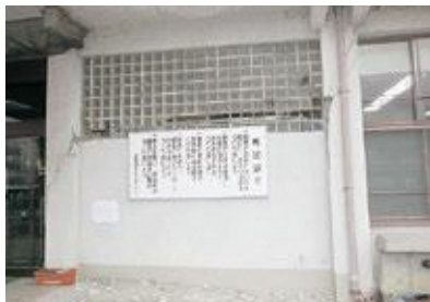
庁舎 正面玄関の壁崩落、ガラス破損 （平成23年3月12日）
