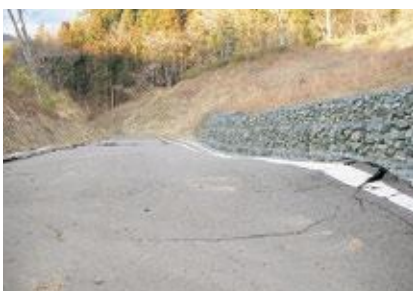
小綱木地区 鼠喰前・東大柴線 波打つ路面と亀裂(平成23年4月4日)
