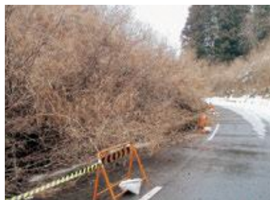
小綱木地区 花塚後沢線 法面崩落(平成23年3月15日)
