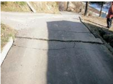
飯坂地区 中下・峠線 路面亀裂(平成23年3月18日)
