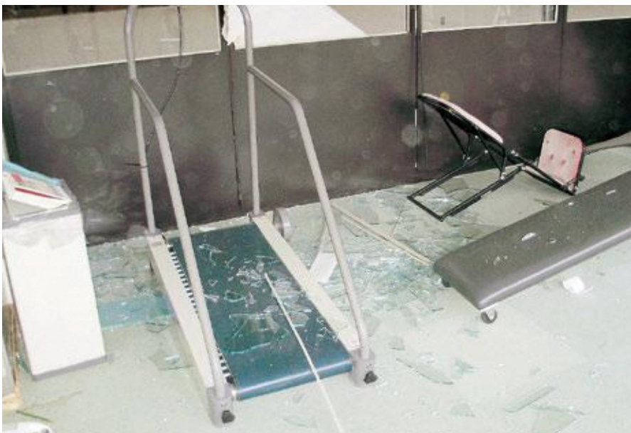
町体育館 2階トレーニング室の被災の様子 (平成23年3月11日)
