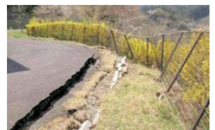
町体育館 敷地の亀裂、外柵倒壊 (平成23年4月28日)
