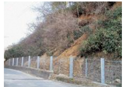
飯坂地区松ヶ柴線 法面崩落(平成23年3月12日)
