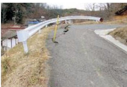
川俣地区 大作・小作支線6号 路面亀裂(平成23年3月21日)
