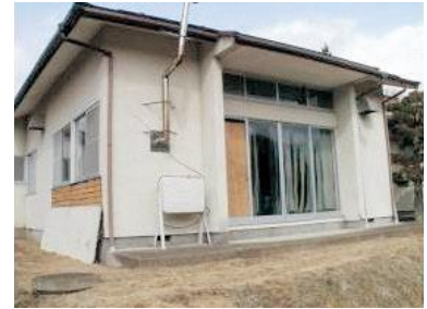
被災した飯坂生活改善センター (平成24年1月30日)
