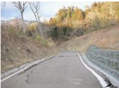
小綱木地区 鼠喰前・東大柴線 路面亀裂(平成23年4月4日)
