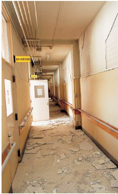
(左) 庁舎 廊下の壁崩壊(平成 23 年 3 月 11 日)
