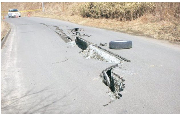
(上) 山木屋地区 山木屋田代線 路面陥没、亀裂 (平成 23 年 3 月 12 日)
